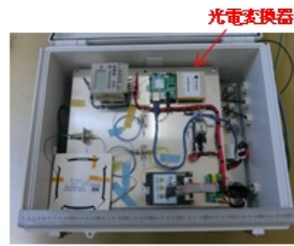
写真2 制御装置BOXの内部
