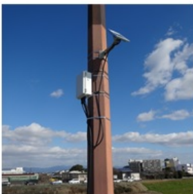
写真6.1 小型太陽光パネル、データ収集・通信装置の設置
