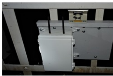
写真6.2 データ収集・通信装置の設置
